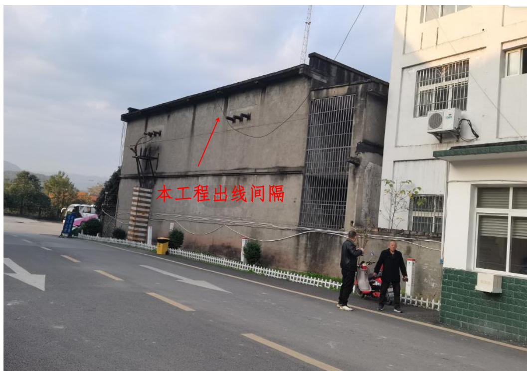
图 2.1-2 林庆站 35kV 出线现状照片
