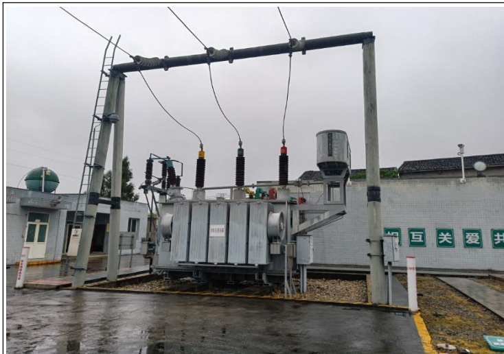
已建卫桥 110kV 变电站照片
