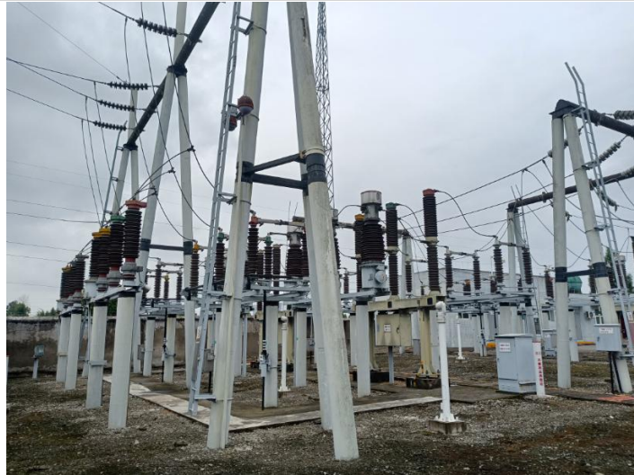
已建卫桥 110kV 变电站照片
