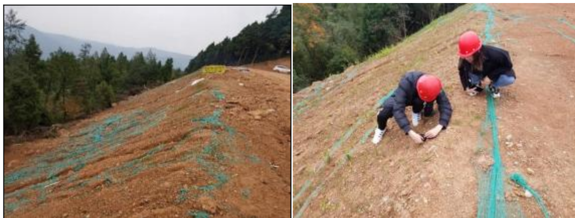
图6.1-1同类项目边坡侵蚀沟
