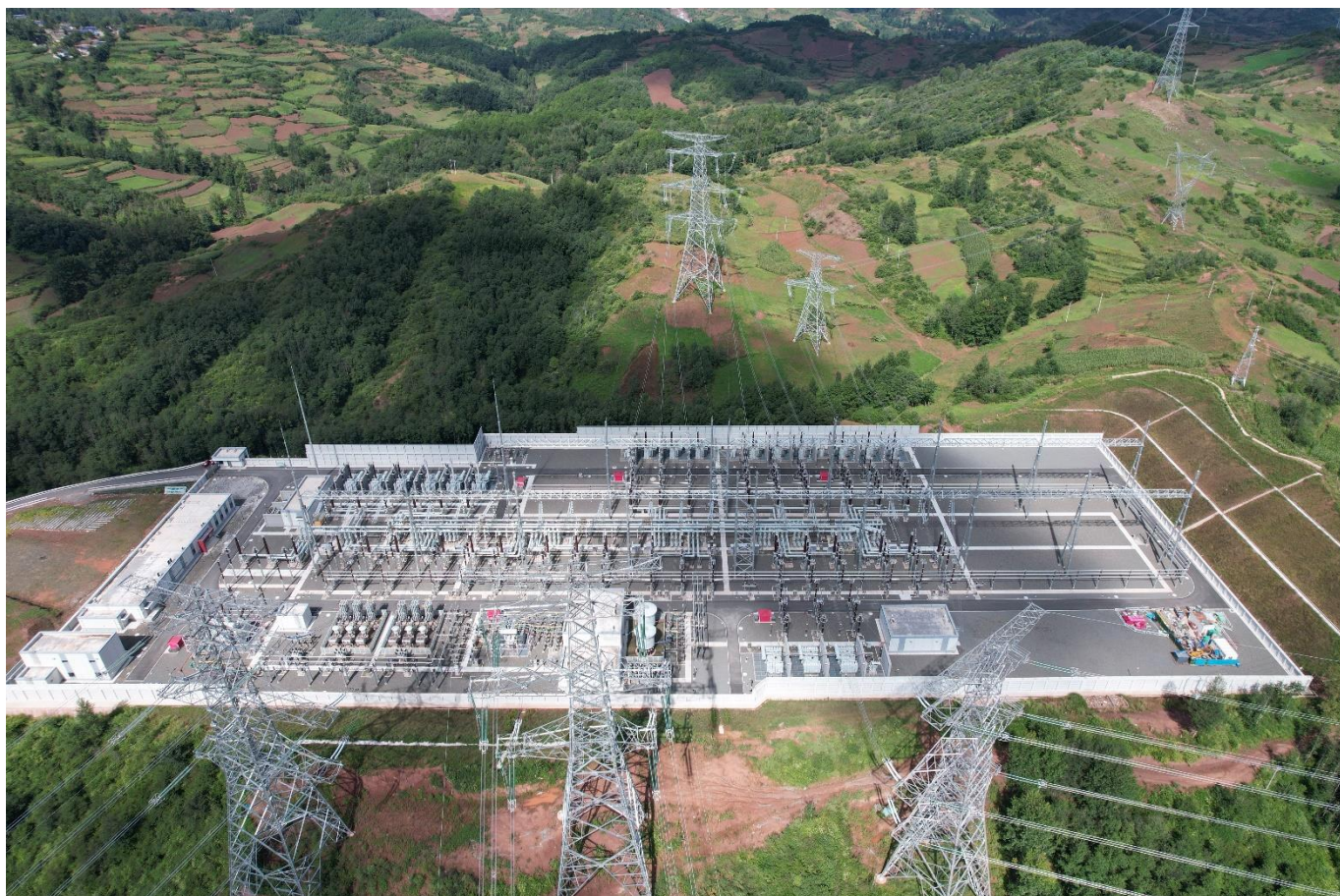
新建开关站现状航拍图
