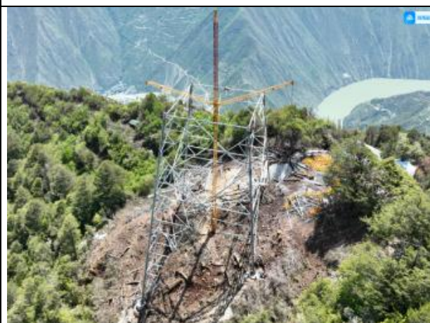
2L026施工现场限界措施未完善；施工过程中苫盖、铺垫措施未完善。
