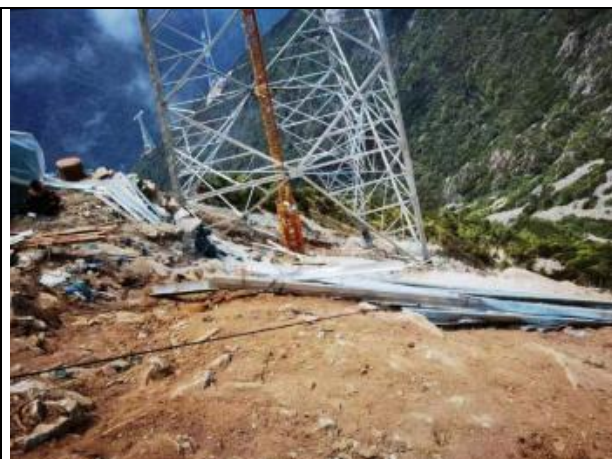
1L100施工现场限界措施未完善；施工过程中苫盖、铺垫措施未完善。
