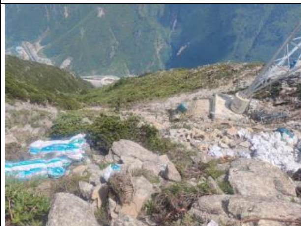
1L103现场余土未外运；现场存在顺坡溜渣现象；现场垃圾未清理完善。
