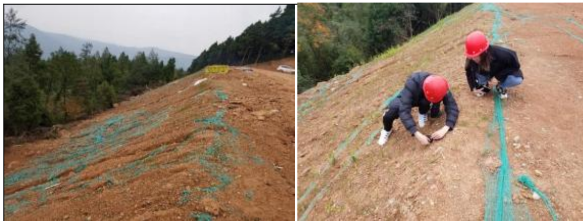
图6.1-1同类项目边坡侵蚀沟
