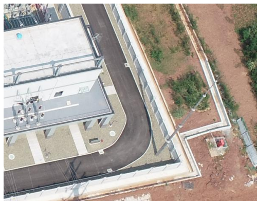
变电站站区截水沟和边坡绿化（部分裸露）
