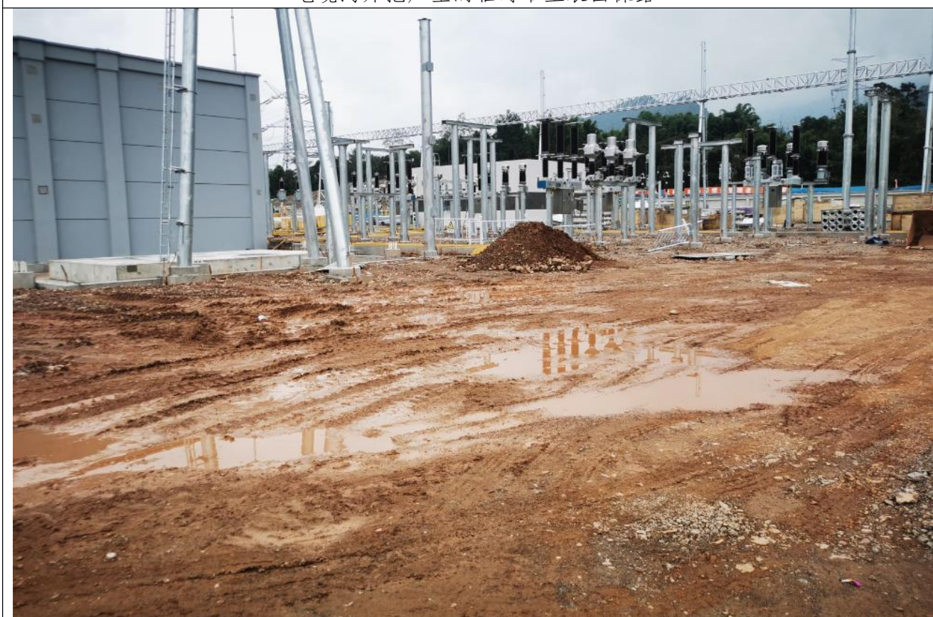
电缆沟开挖产生的临时堆土表面裸露，建议备足防雨布，雨前对裸露地表进行遮盖
