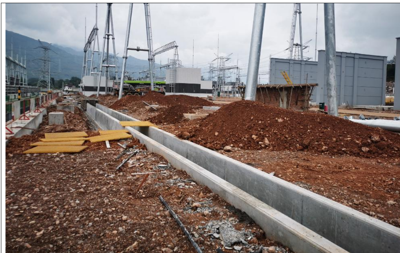
电缆沟开挖产生的临时堆土表面裸露
