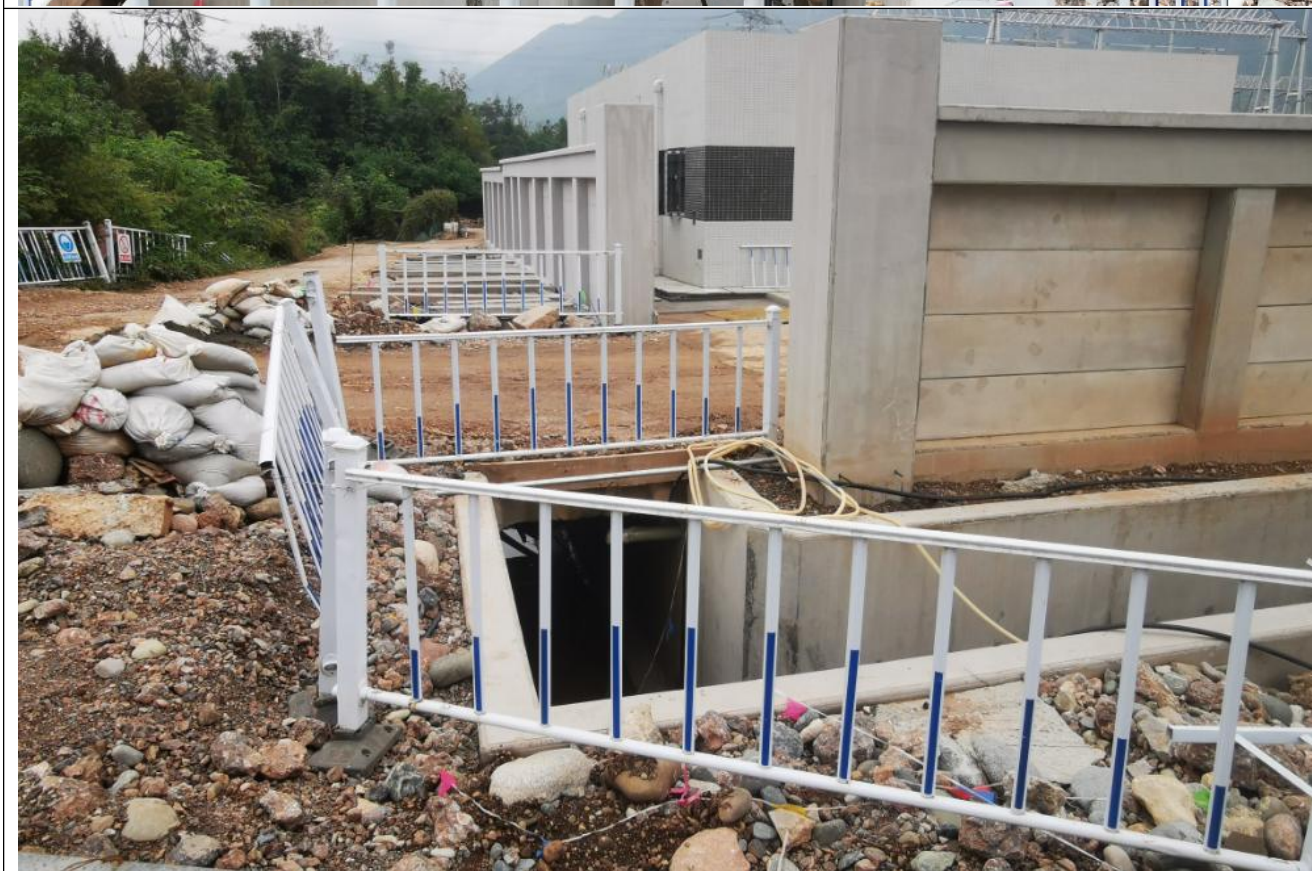
开关站周边围墙及排洪沟
