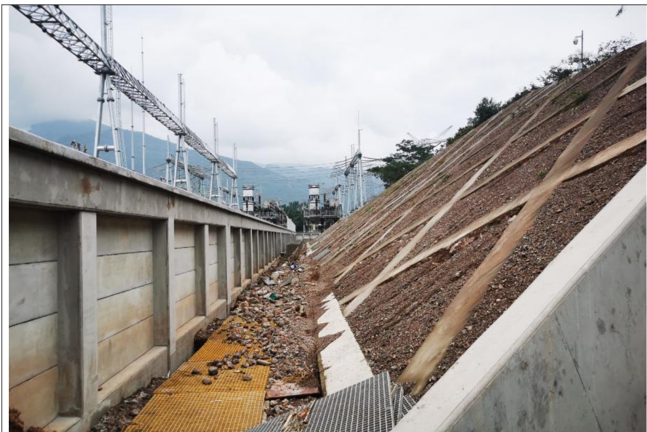
开关站东北侧边坡框架护坡，边坡顶部设截水沟，底部设排洪沟，建议尽快进行撒播草籽
