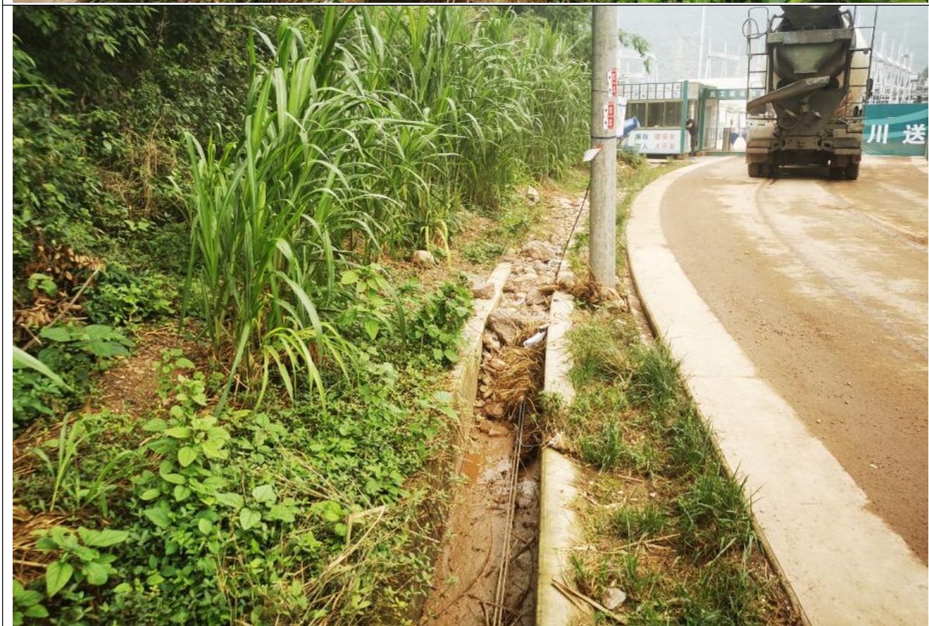
进场道路排水沟及被碎石堵塞排水沟
