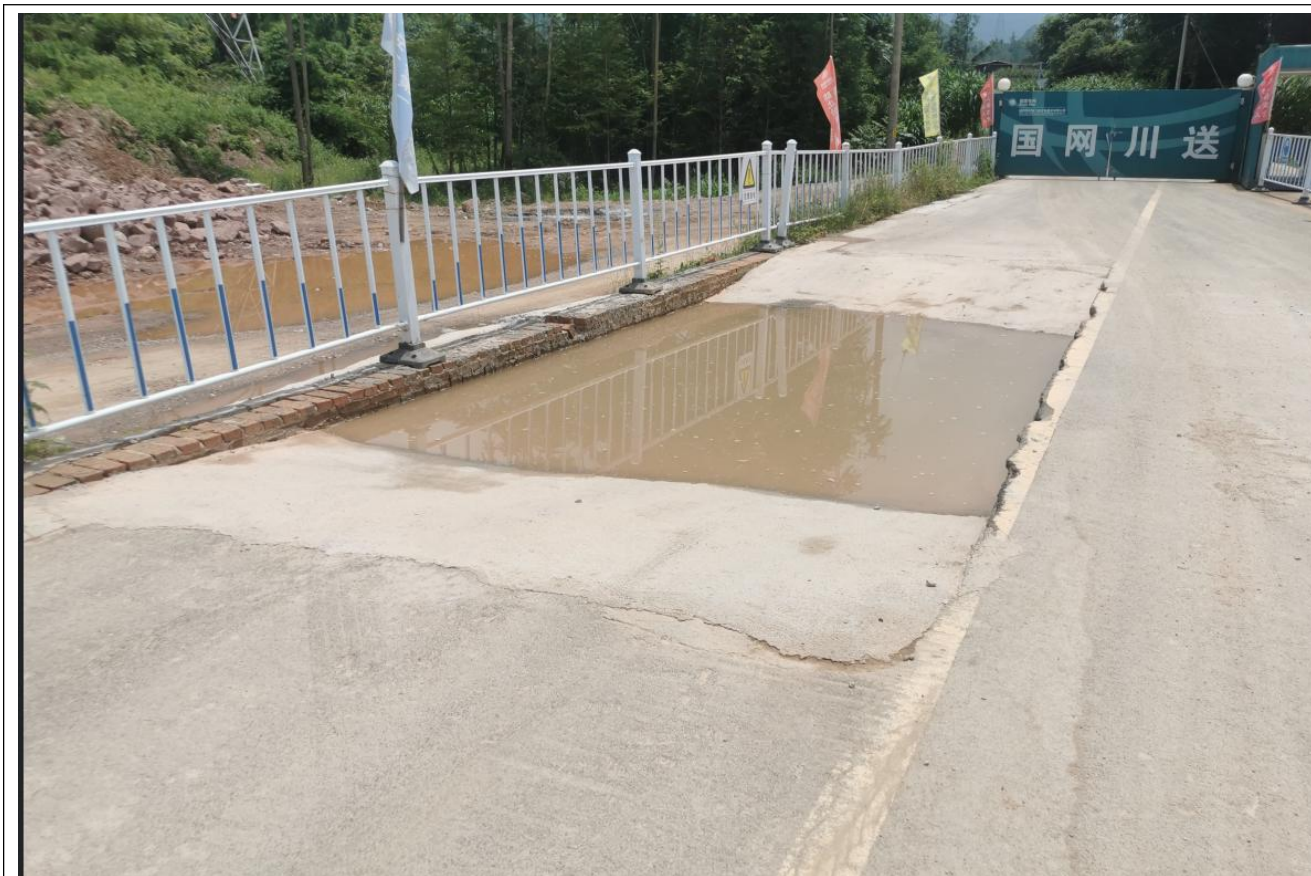
场地出入口新设置洗车槽
