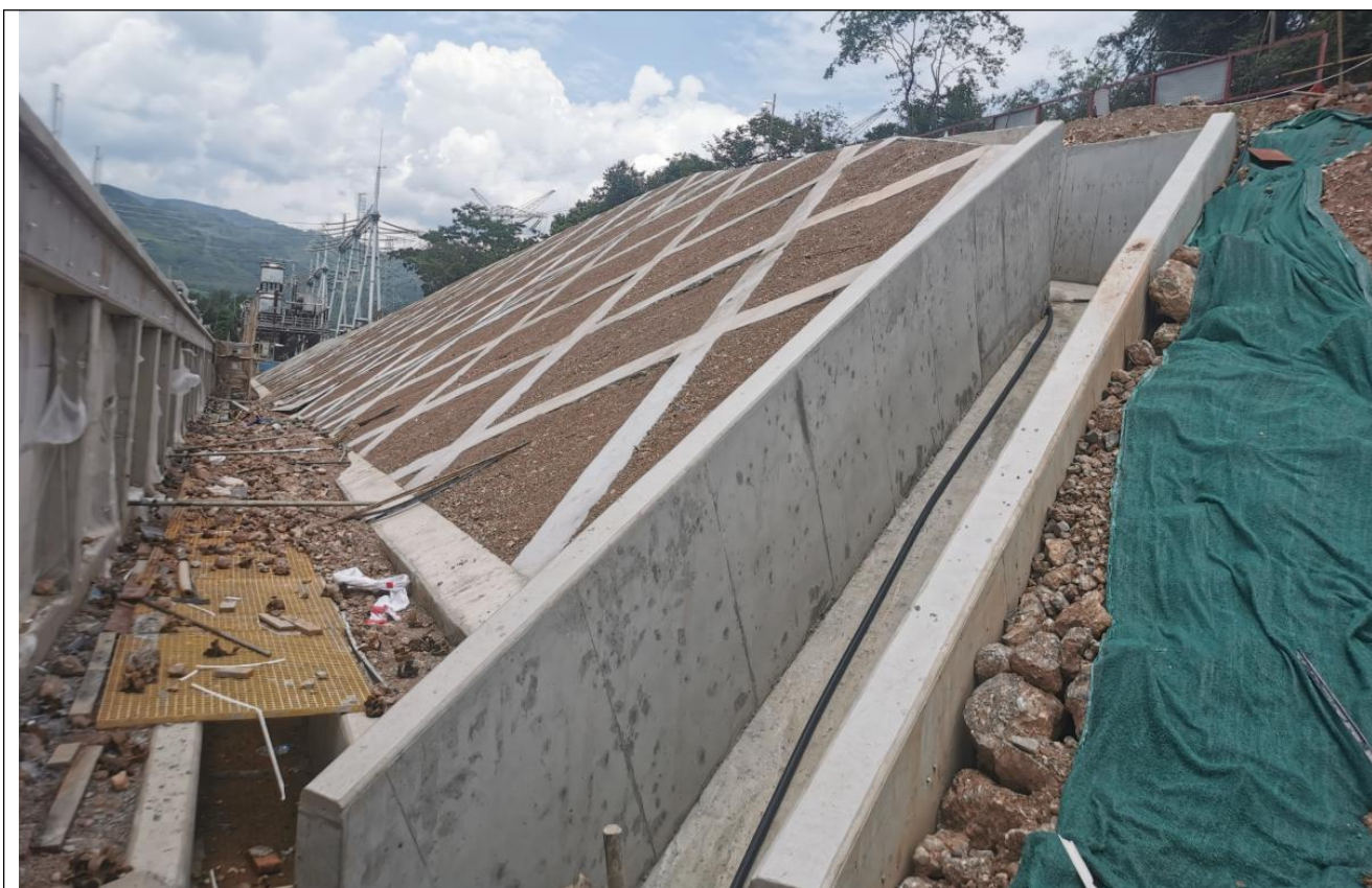
开关站东北侧边坡框架护坡，边坡顶部设截水沟，底部设排洪沟，建议尽快进行撒播草籽
