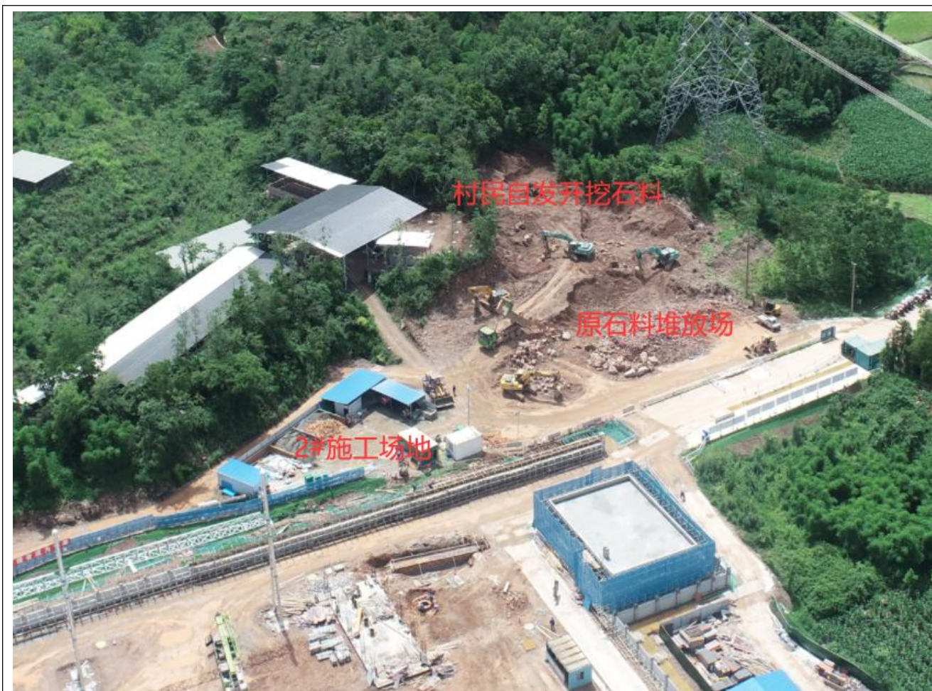
2#施工场地和原石方临时堆放场现状，村民自发向深处开挖石料
