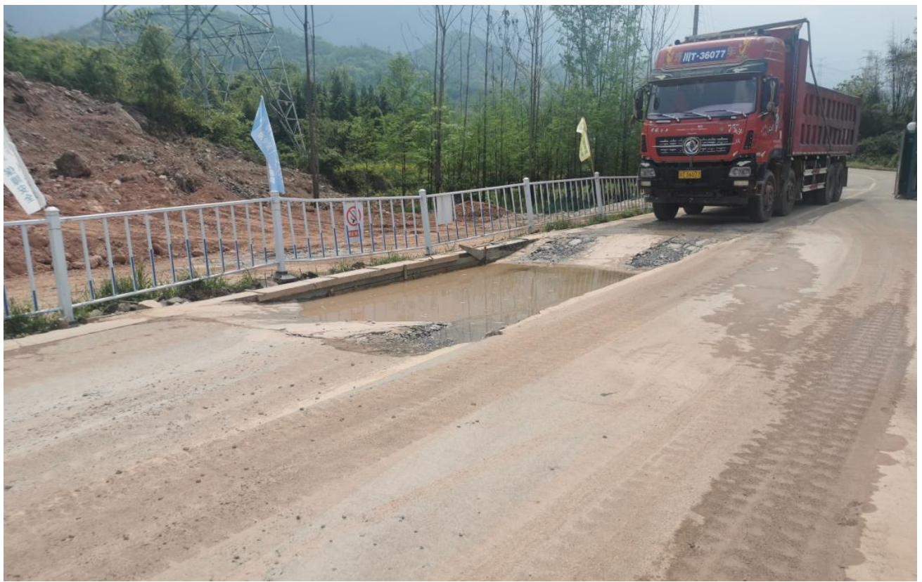
场地出入口新设置洗车槽
