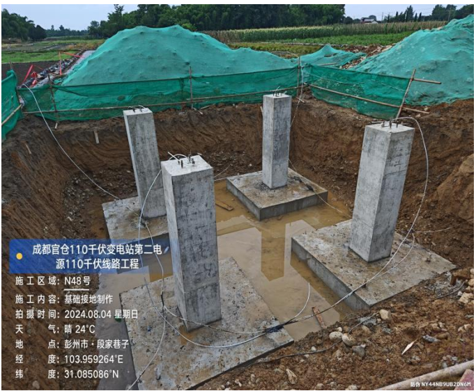
图 4.3-12 N48 塔基施工过程中未对开挖产生的裸露边坡进行遮盖
