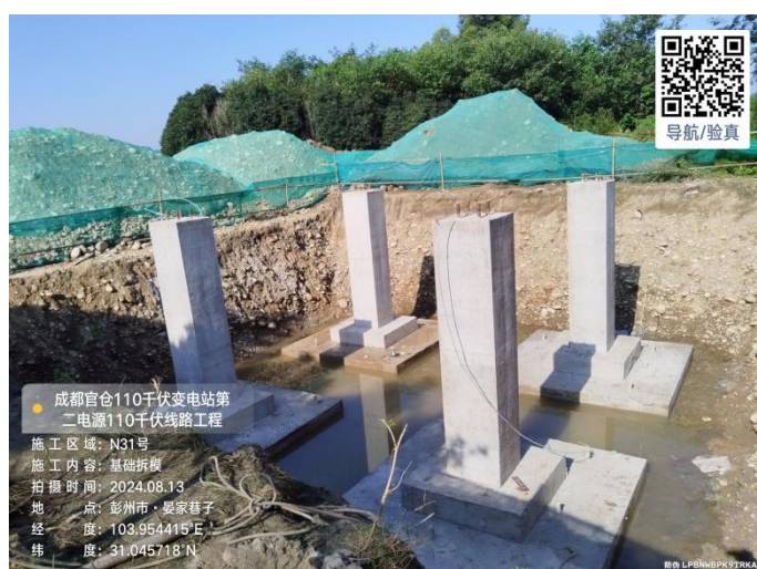
图 4.3-8 N37 塔基施工过程中未对开挖产生的裸露边坡进行遮盖
