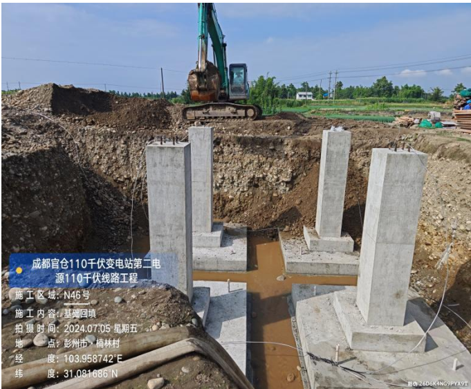
图 4.3-11 N46 塔基施工过程中未对临时堆存在的土石方未有效拦挡、遮盖，对开挖产生的裸露边坡未进行遮盖
