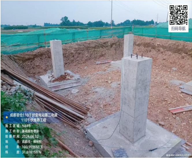
图 4.3-9 N44 塔基施工过程中未对开挖产生的裸露边坡进行遮盖
