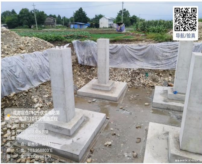
图 4.3-10 N45 塔基施工过程中未对临时堆存的土石方进行有效拦挡、遮盖
