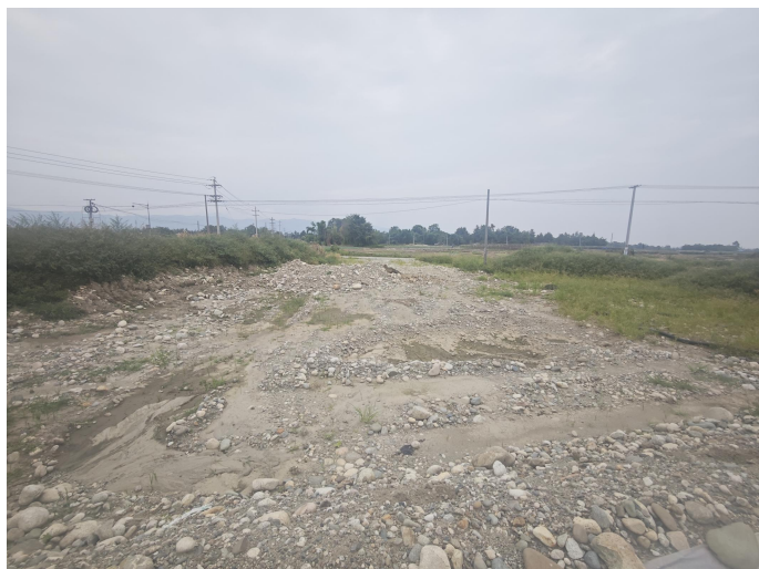
图 4.3-5 N45 塔基施工临时占地区及施工道路区存在建渣未清理，无遮盖、拦挡。
