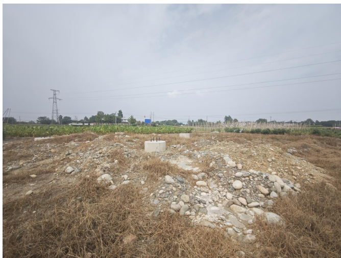
图 4.3-3 N26 塔基施工临时占地区域存在建渣未清理, 塔
