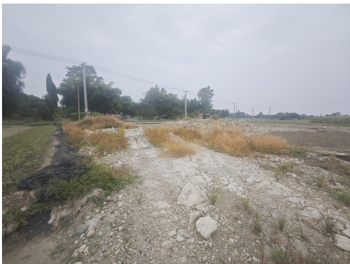
图 4.3-7 N46 施工道路区域存在建渣未清理
