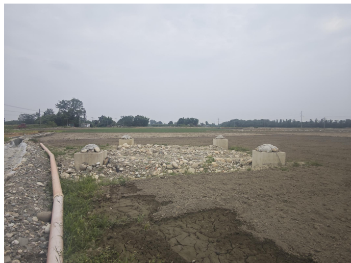
图 4.3-4 N45 塔基施工占地区域存在建渣未清理
