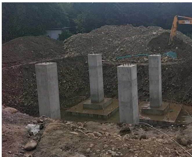
图 4.3-1 N47 塔基施工过程中未对临时堆存的土石方进行有效拦挡、遮盖, 对开挖产生的裸露边坡未进行遮盖
