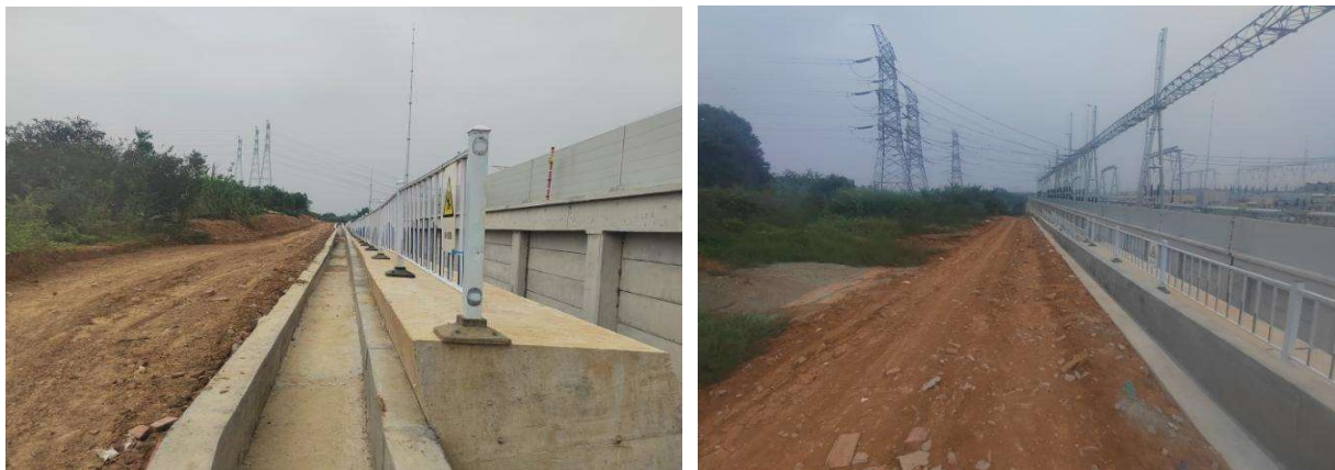
图 4.3-2 还建道路未硬化，路面和边坡裸露未遮盖
