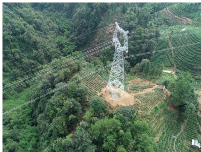
图 4.3-3 NB30 基面有建渣、未进行植被恢复
