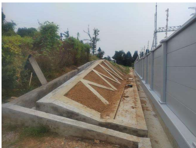
图 4.3-3 站区边坡未进行植被恢复
