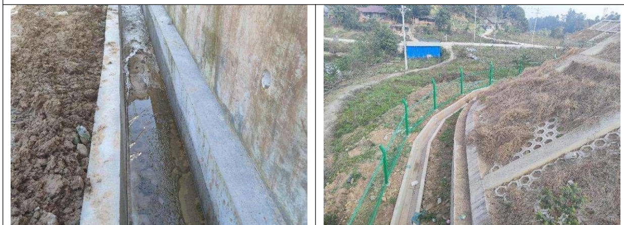
图 3-5 变电站站外排水（2）
