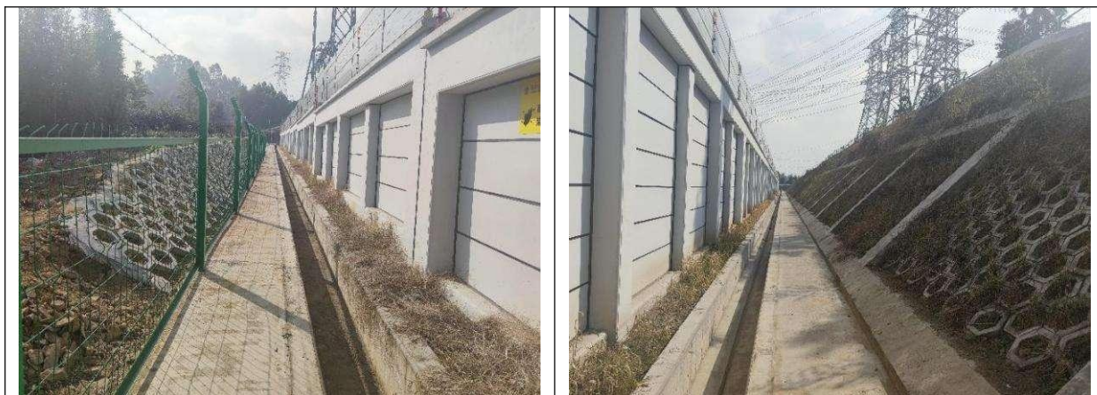
图 3-4 变电站站外排水（1）
