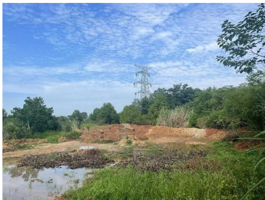
NB5、NC5塔位旁施工临时占地土地整治不到位
