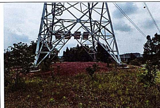
资阳~罗家湾 N56 号塔基区域植被恢复效
