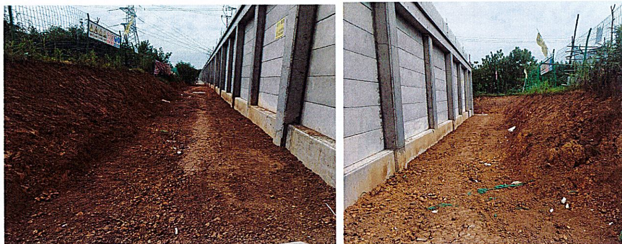
图 4.3-3 站区东北侧围墙外部分区域裸露，未进行植被恢复
