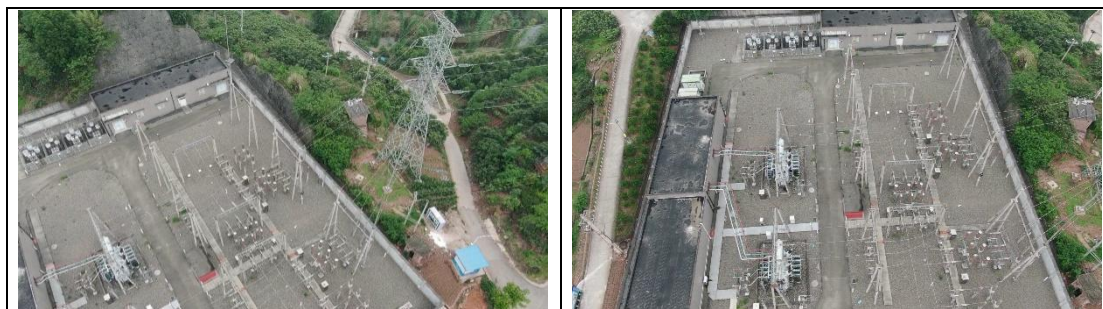
图 2.1-3 35kV 金山变电站运行情况影像资料
