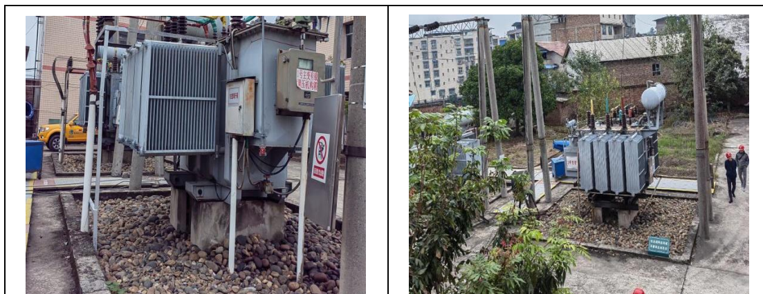
图 2.1-2 35kV 天台变电站运行情况现场照片
