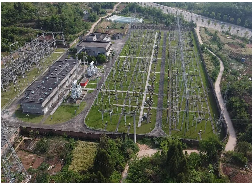
南充大方 220 千伏变电站现状照片
