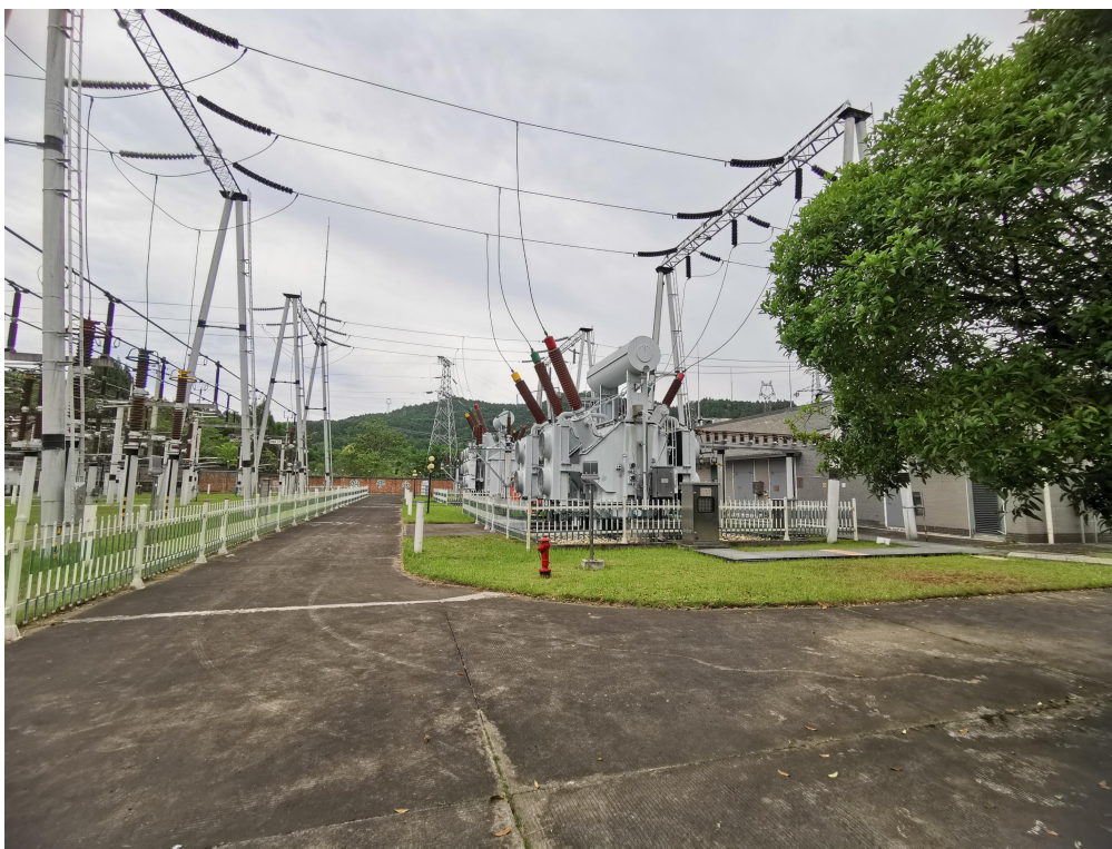
南充大方 220 千伏变电站现状照片
