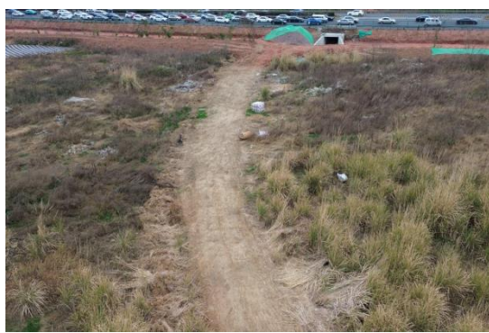
施工道路未铺设钢板等
