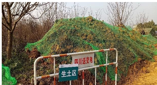
临时苫盖设置不到位
