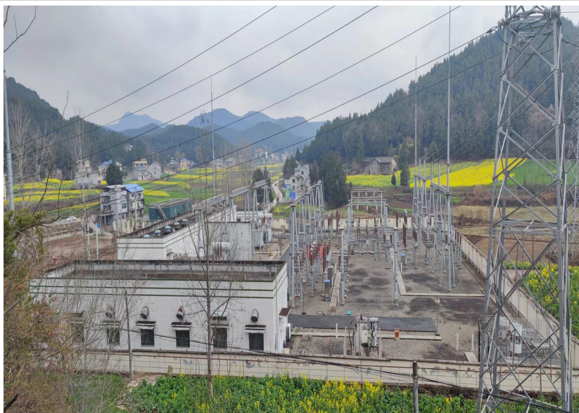
赵家湾变电站照片
