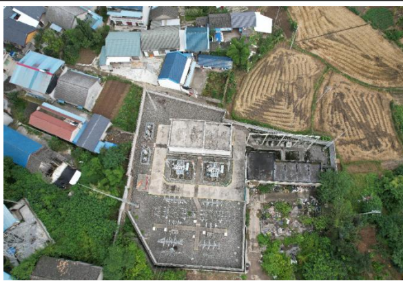
塔水 35KV 变电站
