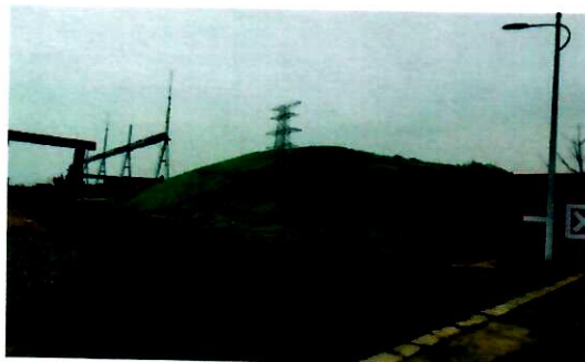
图 4.3-1 进站道路植物护坡尚未实施
