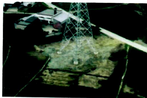
图 4.3-2 NA59 基面有建渣、未进行植被恢复
