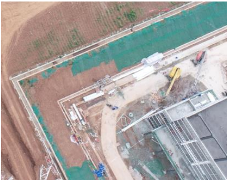
变电站站区截水沟和边坡遮盖
