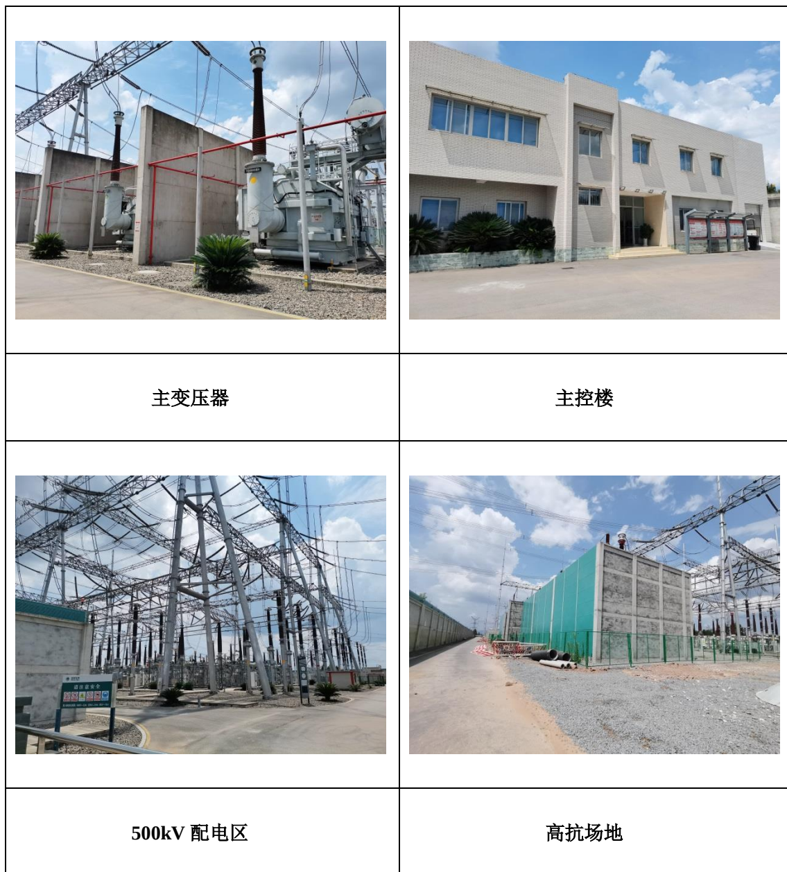
图 3-2 500kV 巴中变电站现状
