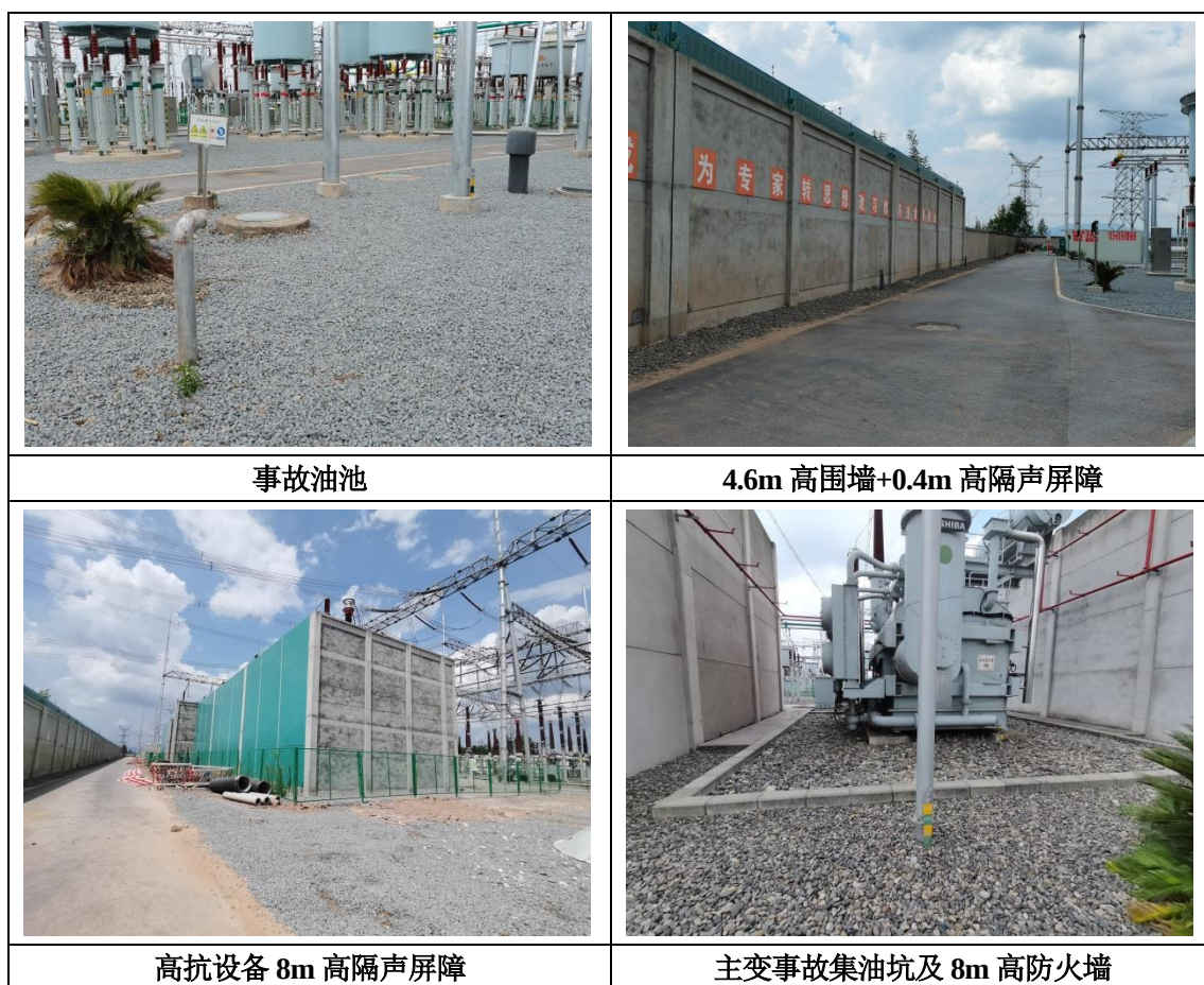
图 3-3 500kV 巴中变电站内现有环保措施
