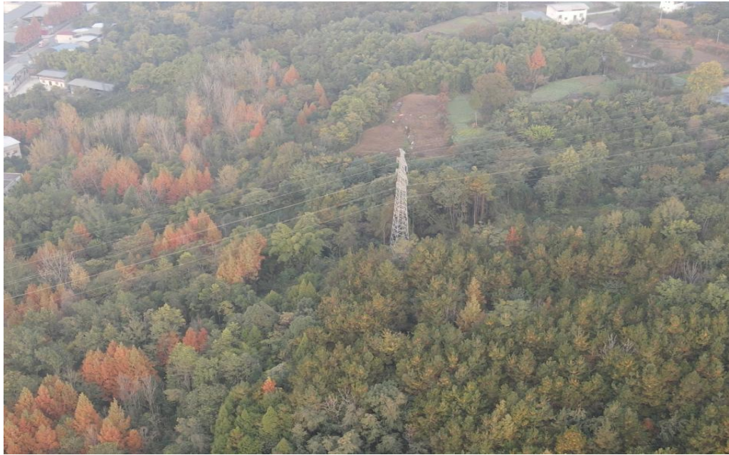
图 3-3 既有 110kV 西太一二线现状
