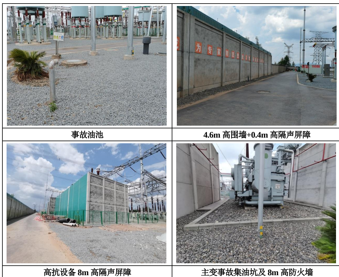
图 3-3 500kV 巴中变电站内现有环保措施
