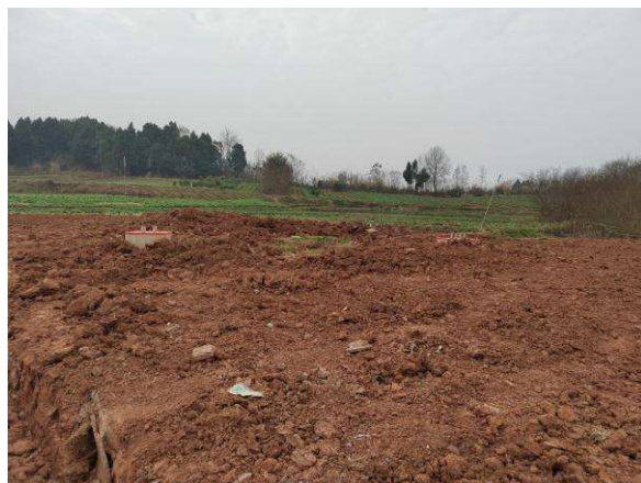
图 4.3-1 N11 号塔位临时堆土未进行有效遮盖
