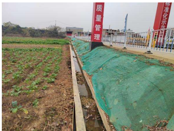
图 4.1 进站道路排水沟淤塞
