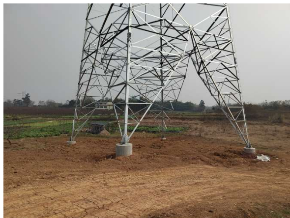
图 4.3-2 塔基基面未进行植被恢复
