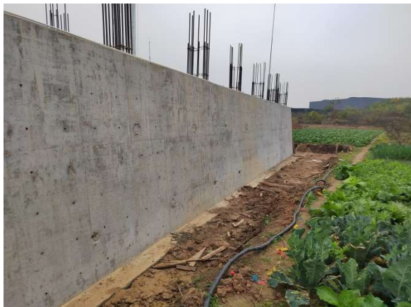
图 4.3-1 站外截排水沟未修筑
