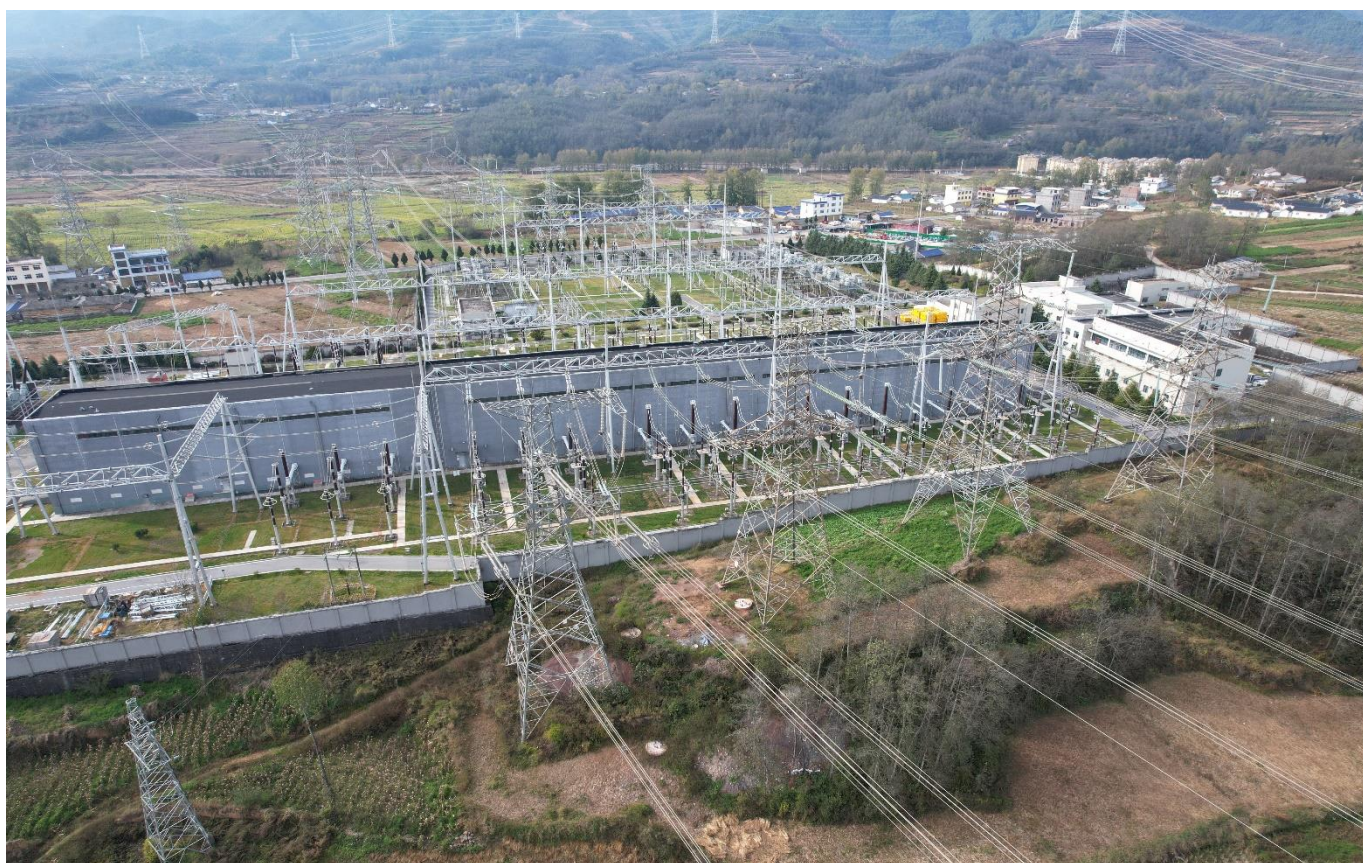
菩提变电站现状航拍图
