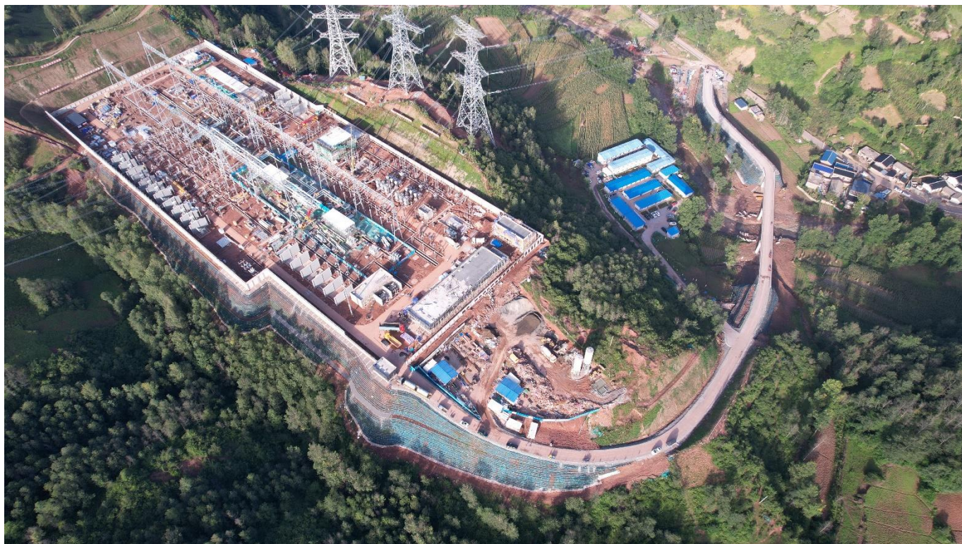
新建开关站现状航拍图
