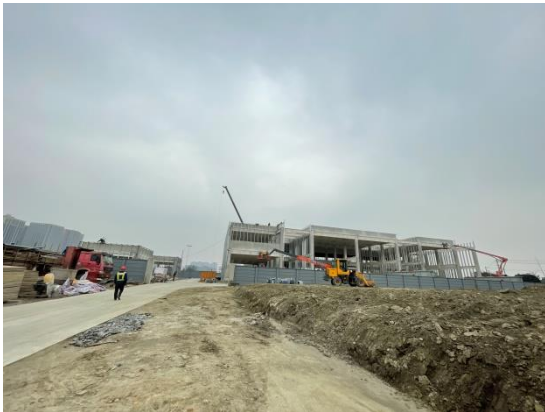
进站道路两侧裸露
