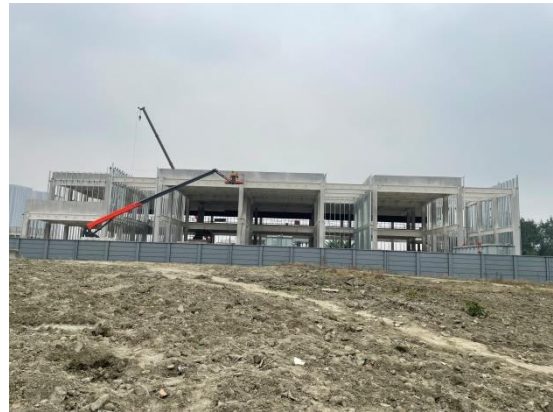
施工临时区和临时堆土区裸露
