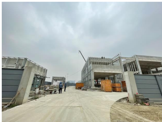
变电站大门进站
