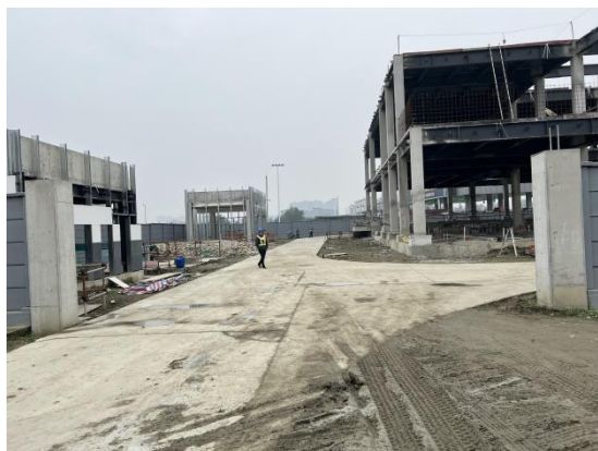
变电站大门进站
