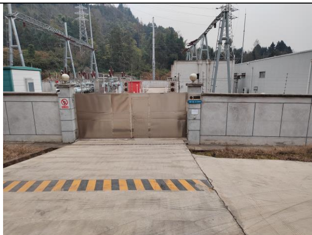
马鞍 110kV 变电站现状
