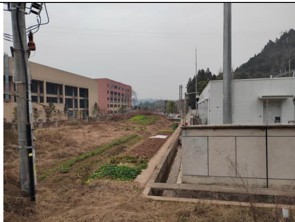
马鞍 110kV 变电站电缆出线情况
