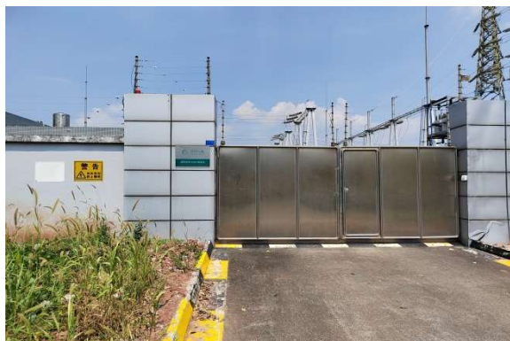
成阿北 110kV 变电站
