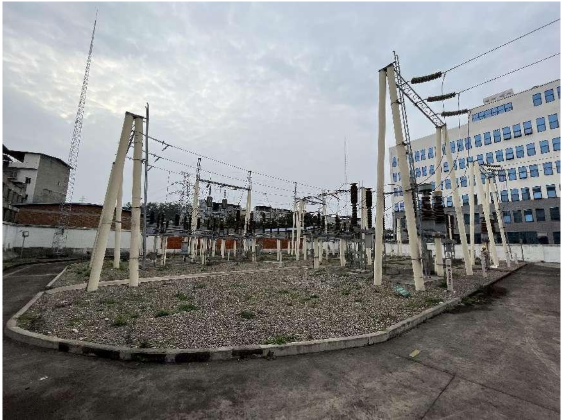
110kV 户外 AIS 装置
