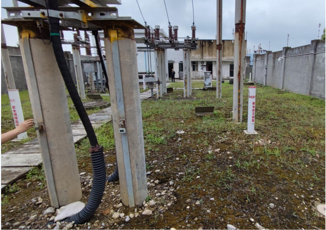
图 2.1-2 左家坡 35kV 变电站现状图
