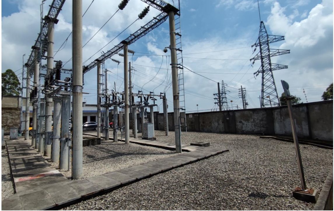
图 2.1-1 墨林 35kV 变电站现状图
