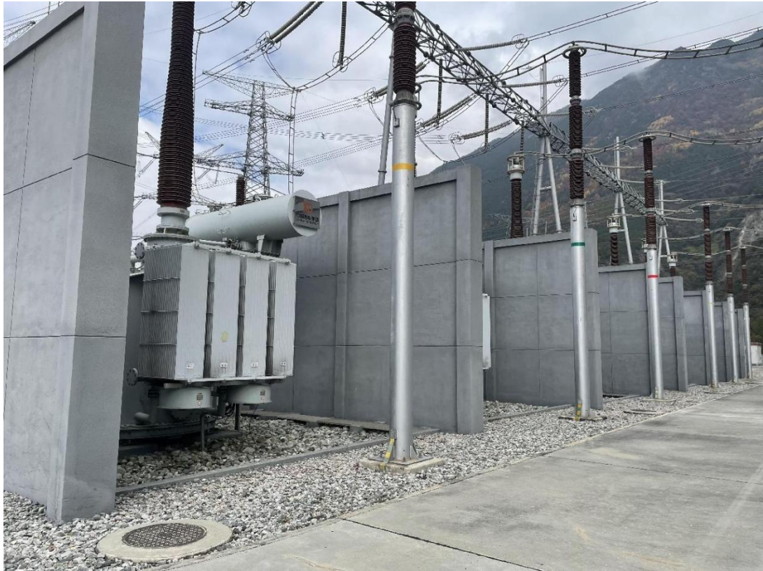
高压电抗器防火防爆墙
