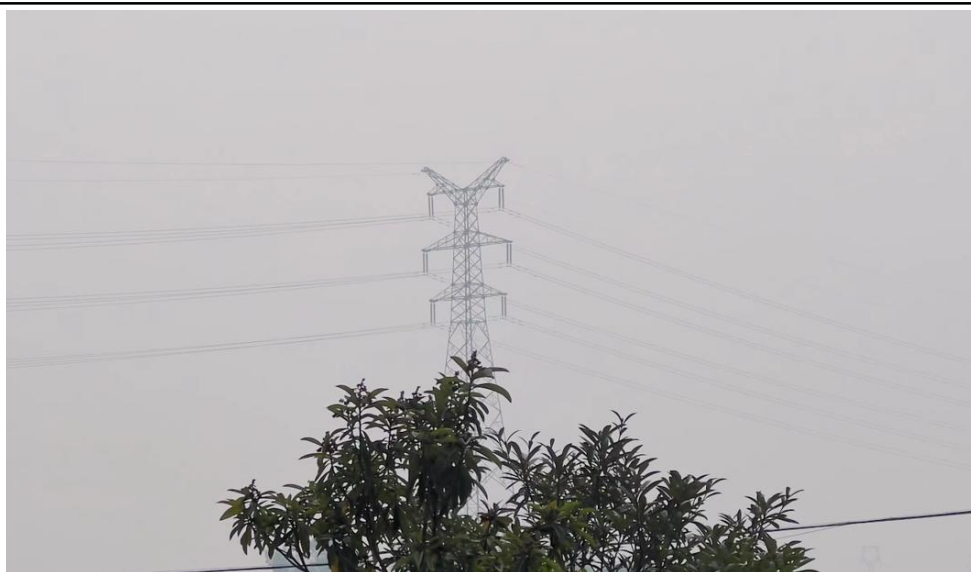
图 3-3 已建 220kV 泸望一、二线现状
