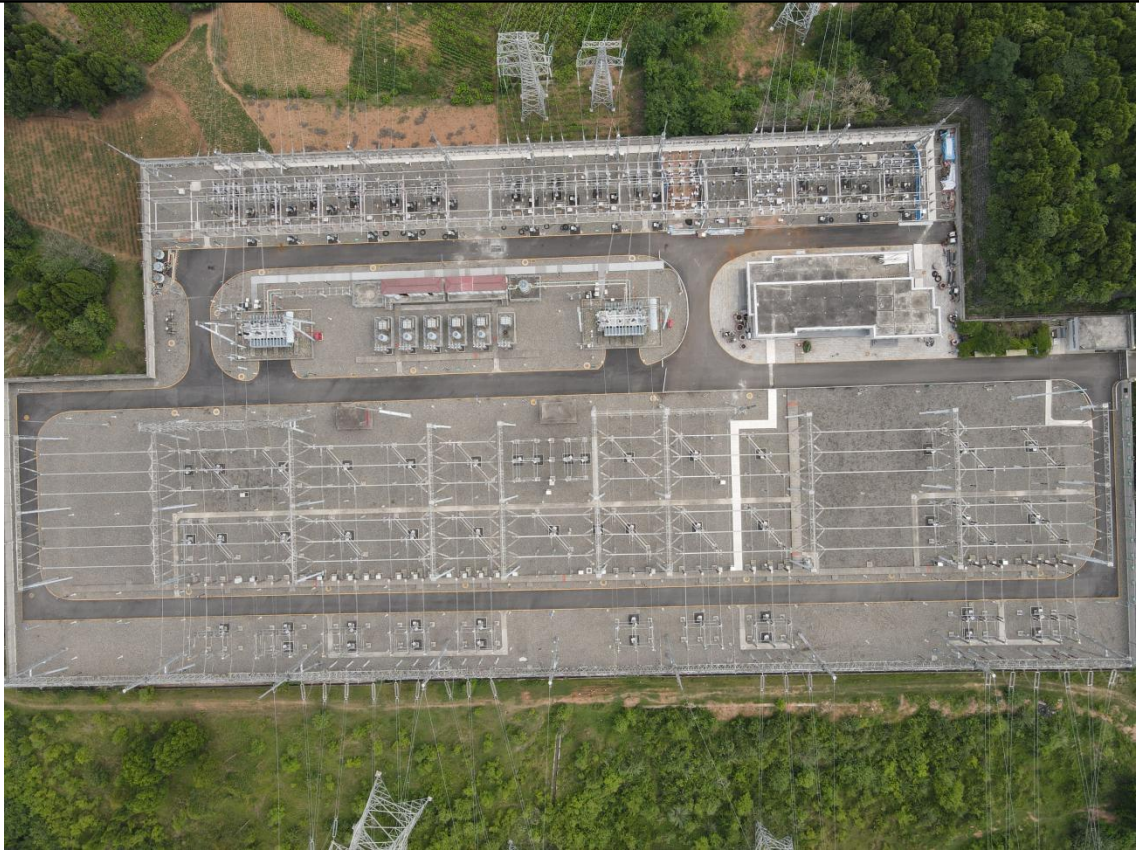
图 3-1 已建劲松 220kV 变电站现状照片
