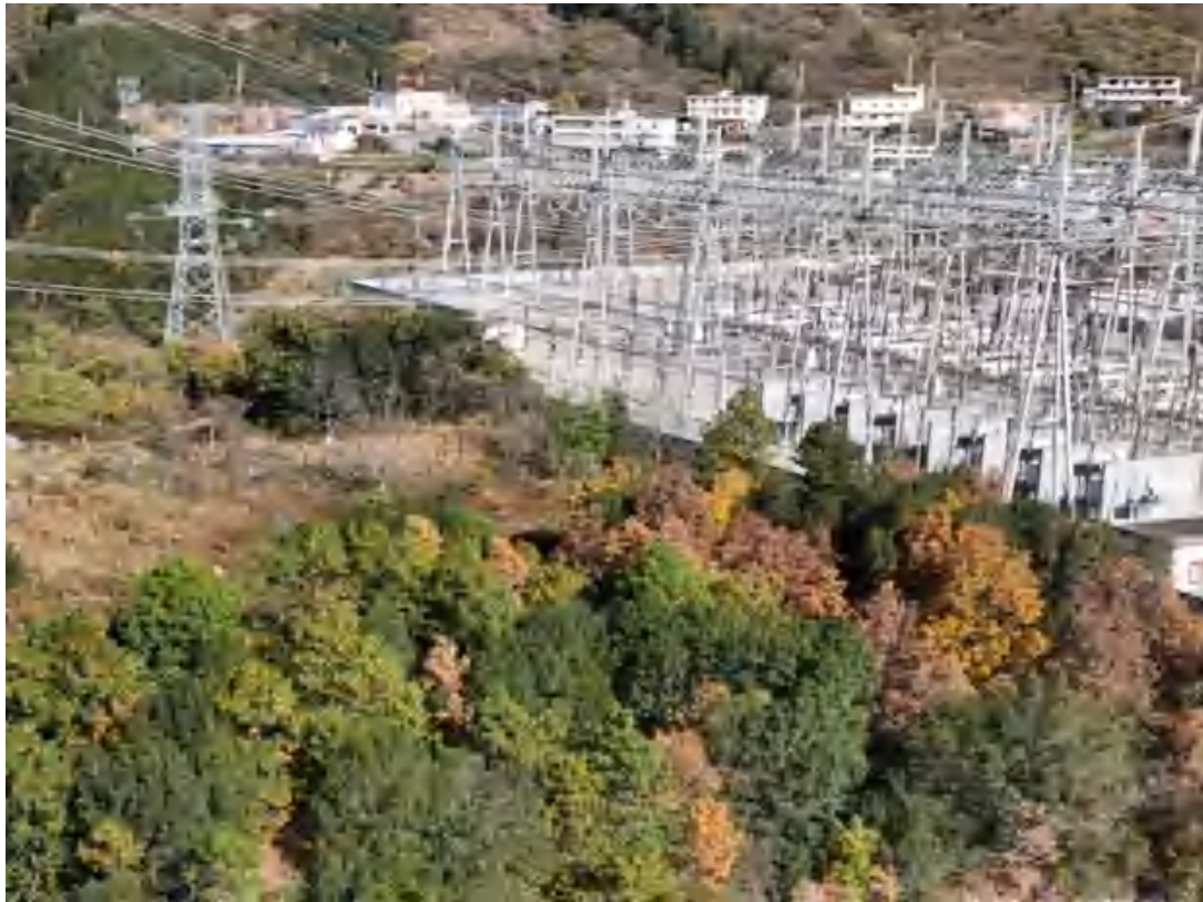
甘谷地开关站区北侧情况
