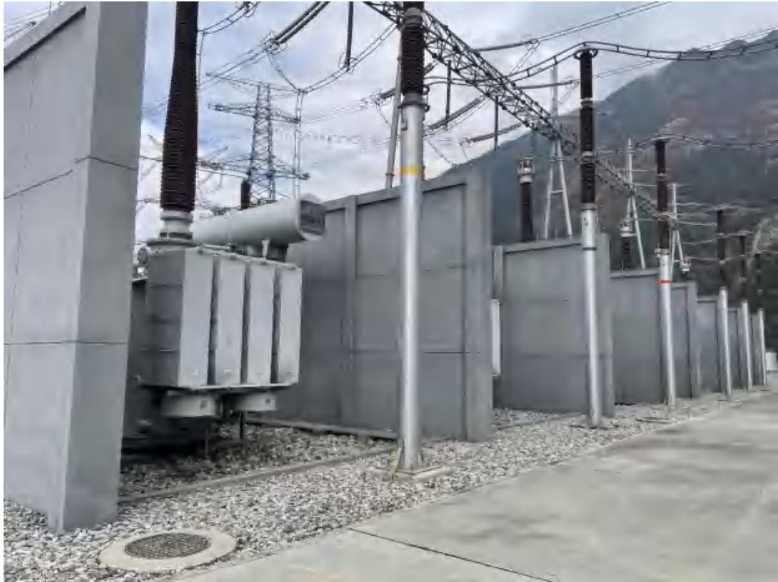
高压电抗器防火防爆墙
