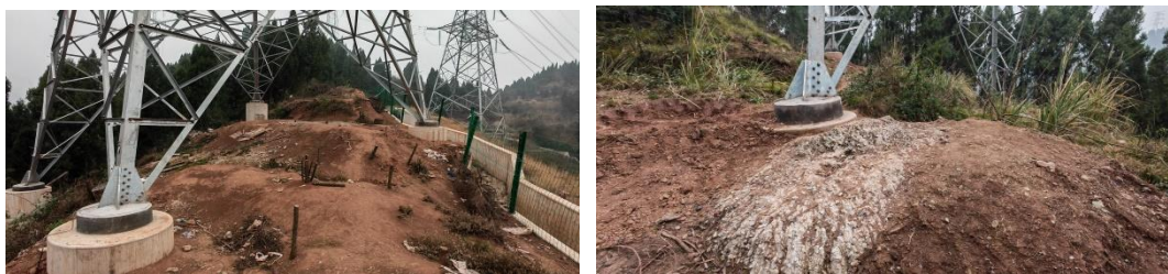
部分塔基建渣未清理、未采取绿化措施
