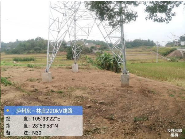
泸州东~林庄 N30 塔
