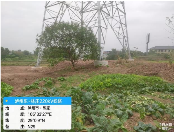
泸州东~林庄 N29 塔
