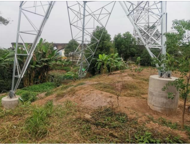
泸州东~林庄 N50 塔
