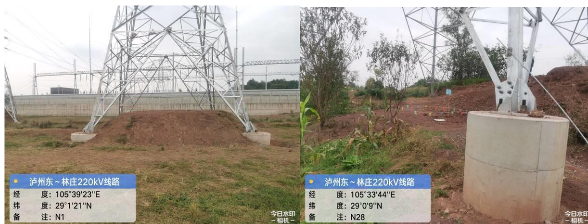
泸州东~林庄 N1 塔
