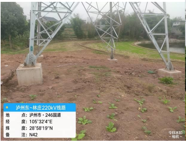
泸州东~林庄 N42 塔
