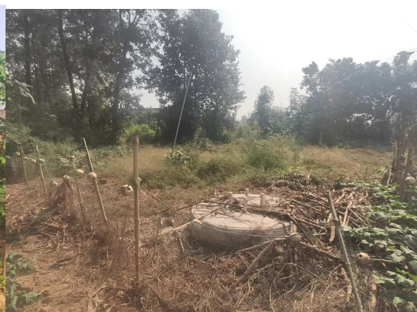
泸州东~林庄 N52 塔
