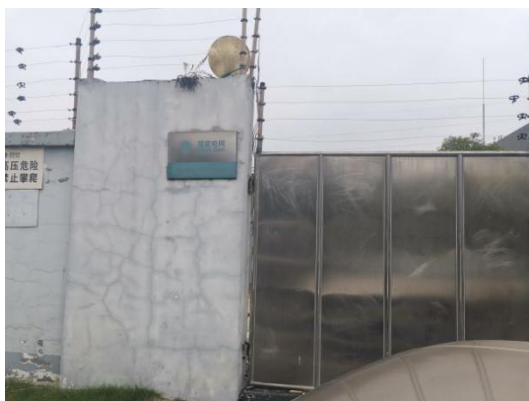
红光 110kV 变电站（运行名雍店变）
