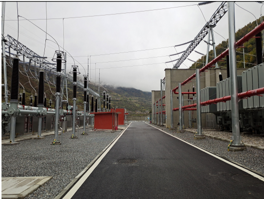
川主寺变电站
