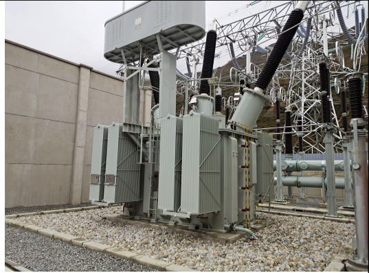
川主寺变电站
