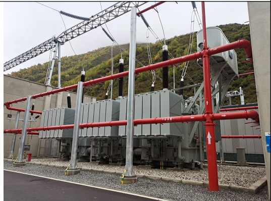
川主寺变电站
