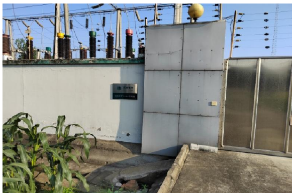
文武（顺江）110kV 变电站
