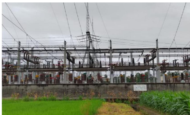
徐家渡变电站出线间隔
