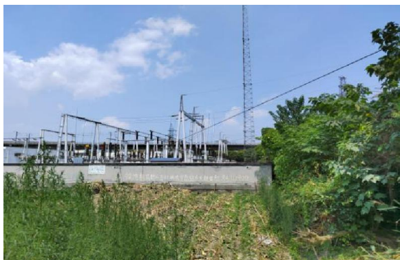
花桥 110kV 变电站进线间隔
