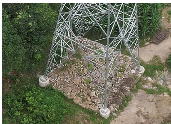
泸州东～泰安 N29 塔基未覆土、绿化
