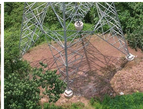
泸州东～泰安 N58 塔基未及时绿化
