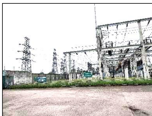
新市220kV变电站站内现状
