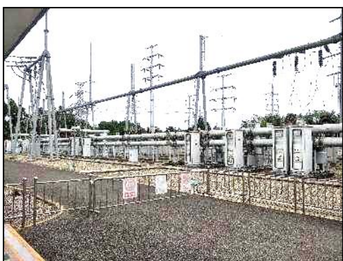
秋月220kV变电站站内现状
