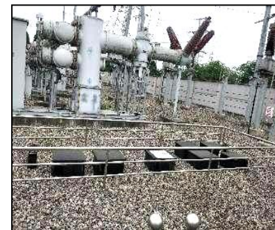
秋月 220kV 变电站生活污水处理设施
