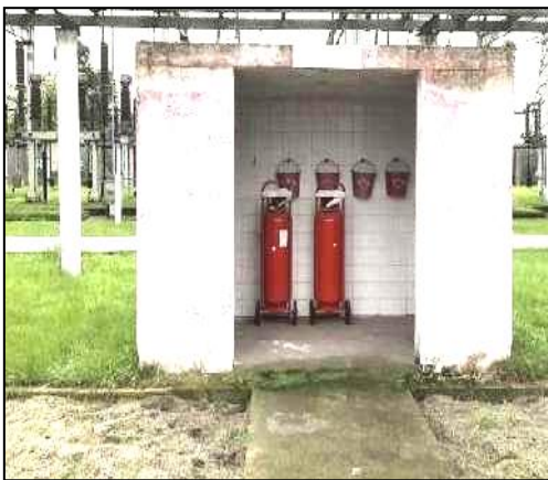
新市 220kV 变电站消防小室
