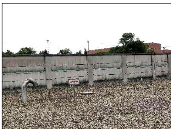
秋月 220kV 变电站事故油池
