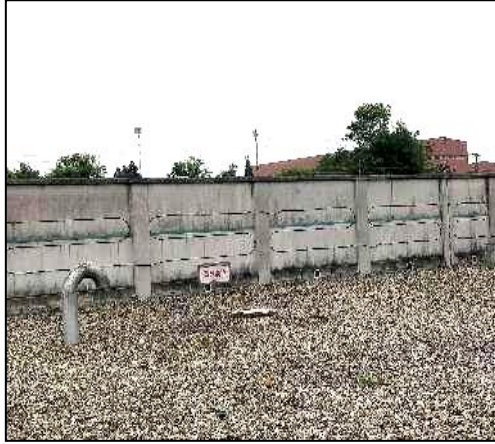
秋月 220kV 变电站事故油池
